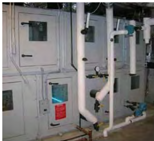
Fotografía cortesía de Engineered Air
